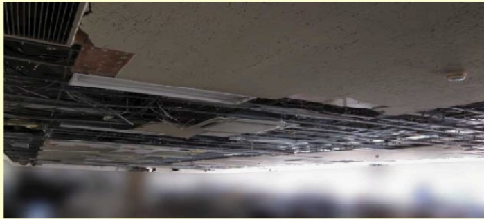
地震により落下した天井
