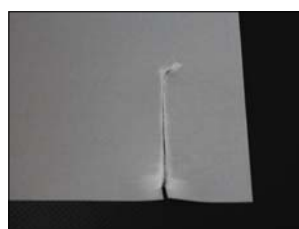
不燃シートの破れ
